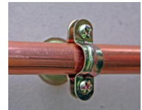
Collier sanitaire - vue en situation
